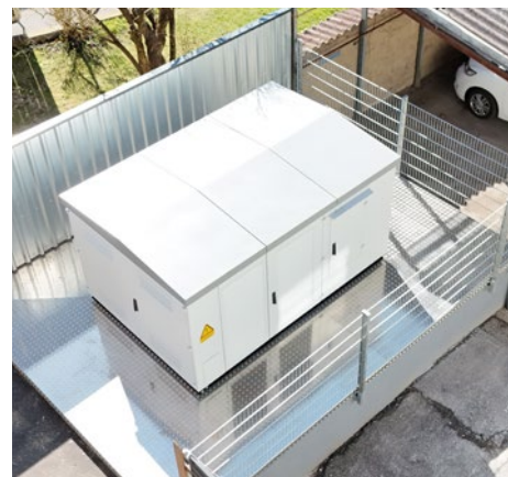
Die neue Trafostation in der Kreuzgasse
